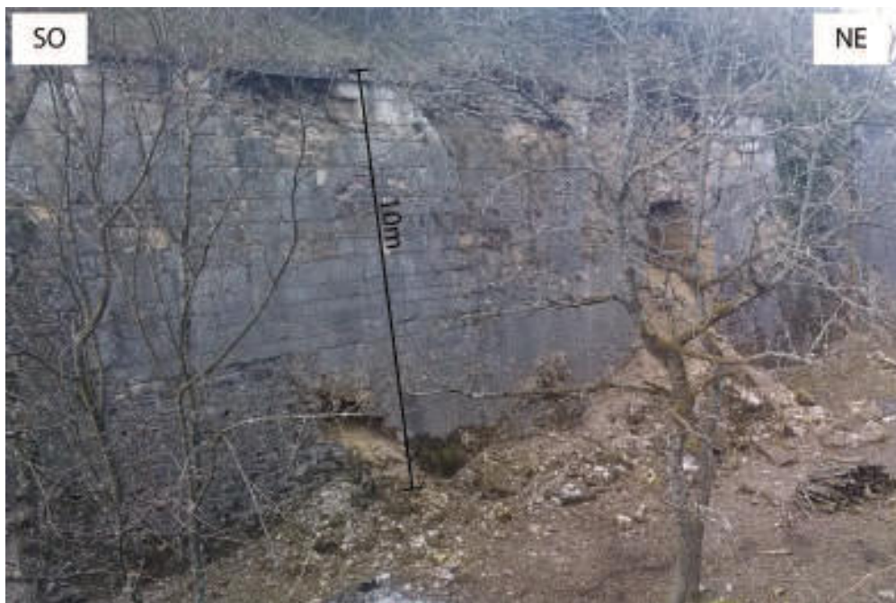
Illustration 33 : Photographie (BRGM) du rempart sud du fort de la Justice partiellement effondré.
